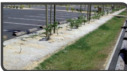
Un fossé sec avec des enrochements permet une bonne gestion des limites et favorise la collecte des eaux de surface et l'infiltration.
